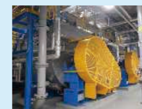
堆肥化(発酵)装置
