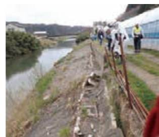
被災した河川護岸の調査
